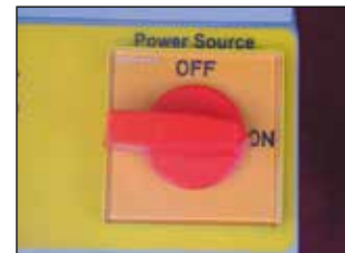
コントローラー電源オン
